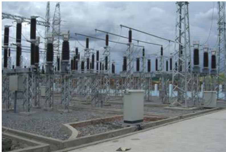
(Ảnh: Trạm phân phối 110kV – Thủy điện Đa Dâng 2)
