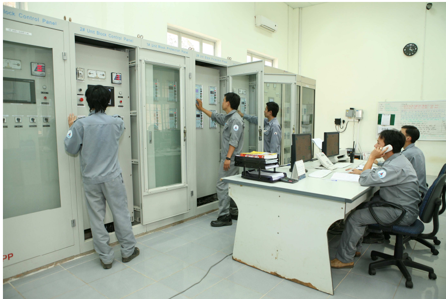
(Ảnh: Nhà máy Thủy điện Đasiat đang vận hành)
