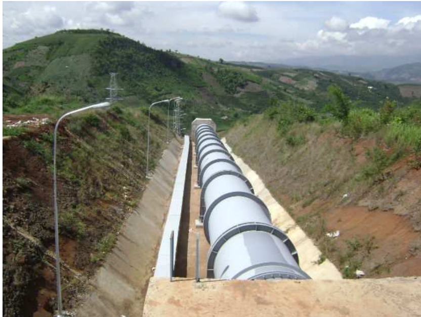
(Ảnh : Đường ống áp lực- Thủy điện ĐA DẮNG 2)
